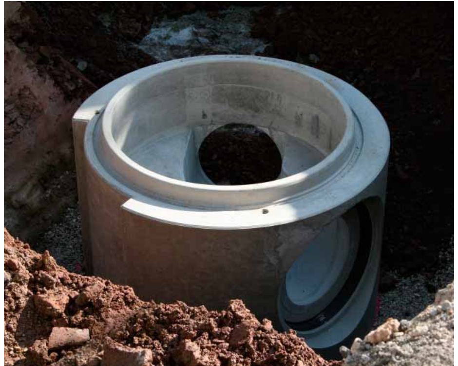
In Neubulach/Altbulach wurden ebenfalls Betonschachtunterteile mit optimierter Wandstärke verwendet
